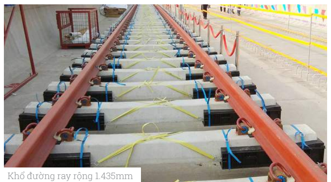
Các thanh đường ray được vận chuyển, tập kết tại khu vực cầu cạn
